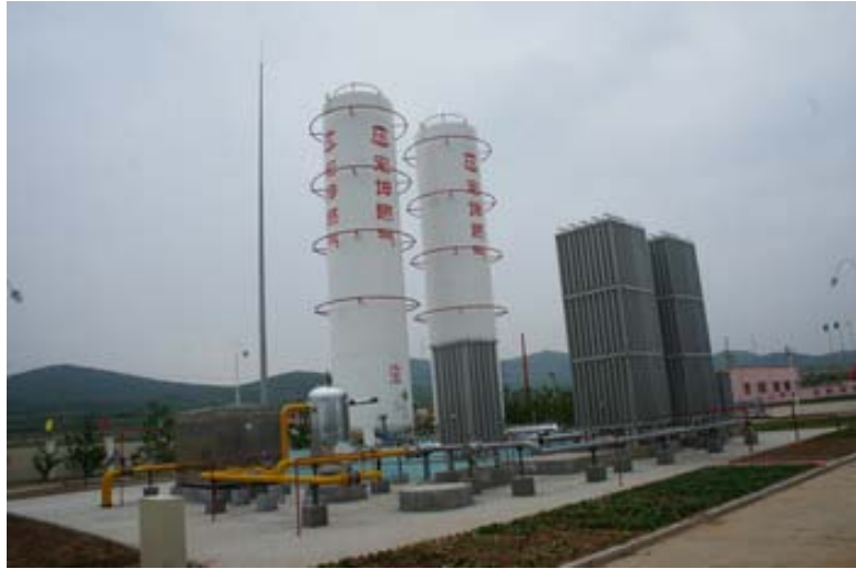
图 14-6 龙川 LNG 储罐气化站
